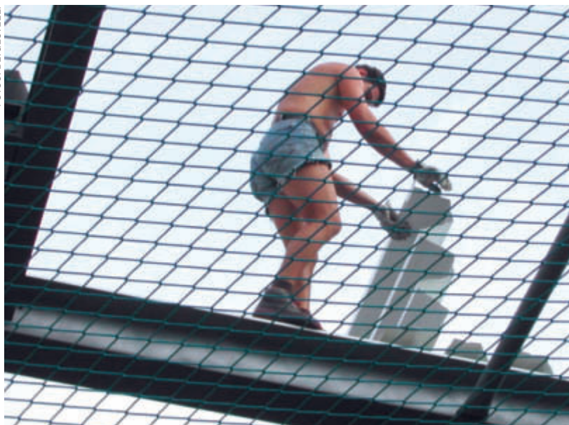
Gesichertes Arbeiten ohne Anseilschutz
