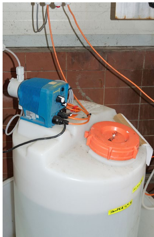
Das neue Korrosionsschutzmittel für den Kessel wird mittels einer Dosiereinheit zugesetzt.
