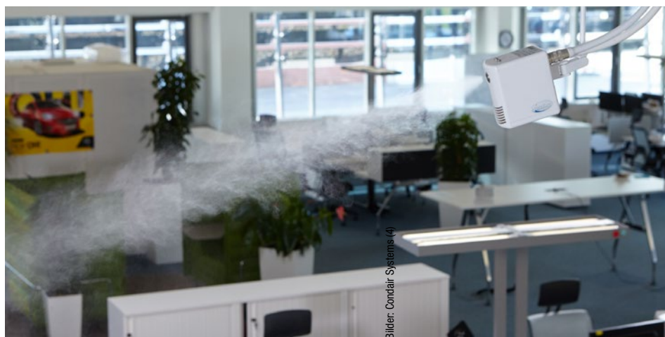
Nachträglich eingebaute Luftbefeuchter können ganzjährig eine Mindestluftfeuchte von 40 % sichern.
