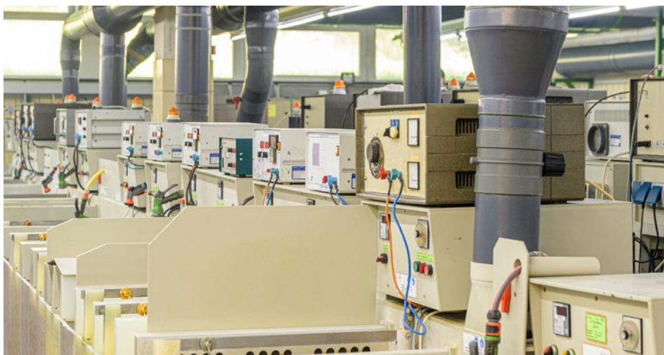
Die Galvanikbecken werden direkt abgesaugt.
