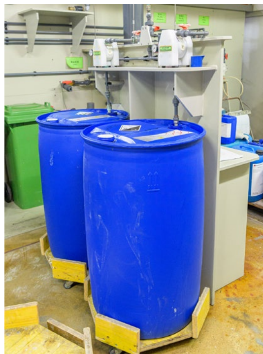
Die selbst gebaute Dosieranlage erspart das händische Einsetzen und Herausheben von Fasspumpen in Chemikalienfässer und damit die Gefahr des Verspritzens von gesundheitsgefährdenden Flüssigkeiten.
